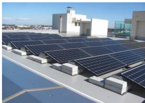
所沢市立富岡中学校の屋上に設置 (所沢市神米金)
