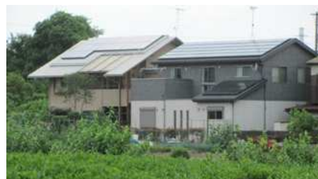
戸建て住宅の屋根に設置 (所沢市花園)
