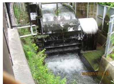
小水力発電(山梨県都留市)
