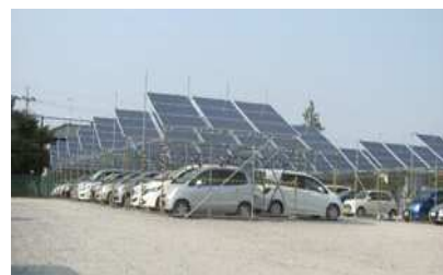
駐車場の屋根に設置 (所沢市下富)
