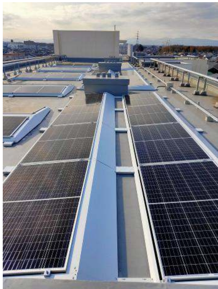
向陽中学校屋上の太陽光発電設備
