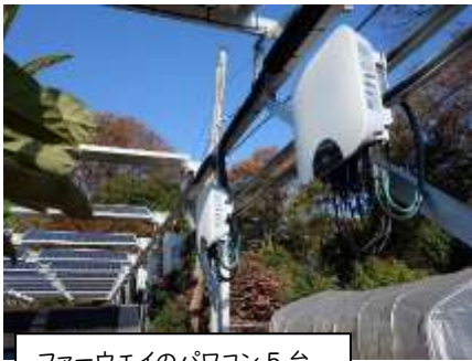
ファウエイのパワコン 5 台、夜間の待機電力は殆どゼロ
