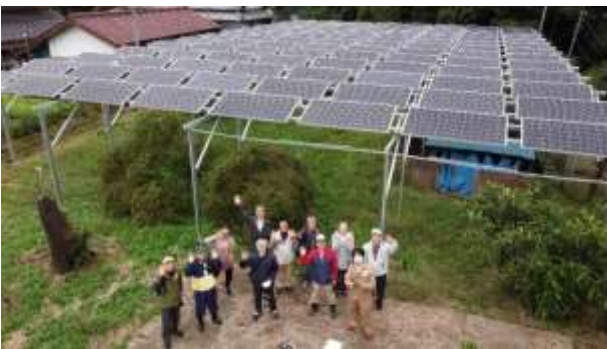
上の写真は、所沢市民ソーラーの山宇農園発電所
